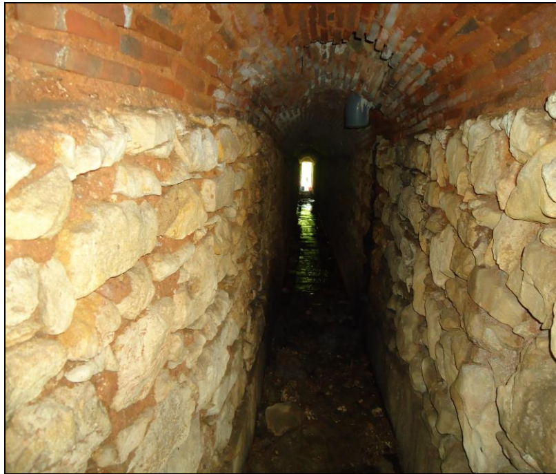
Figura 15. Vista do intradorso da abóbada de berço em tijolo do Túnel da Micha.
