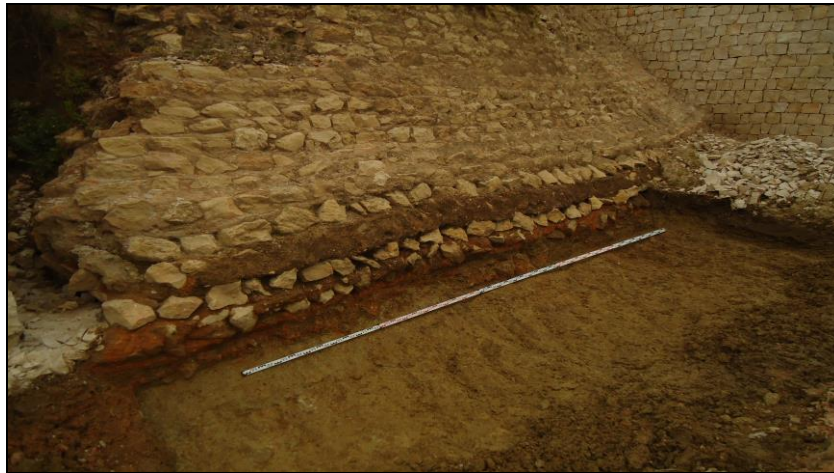
Figura 6. Base do Alambor sobre o estrato geológico, na fase final de escavação com pormenor do estrato de enrocamento que sustenta toda a estrutura. (Autoria Foto: DIAS, Susana)
