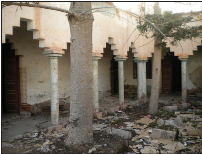
Figura 3. Vista del estado de abandono del pequeño patio de la zona este.
