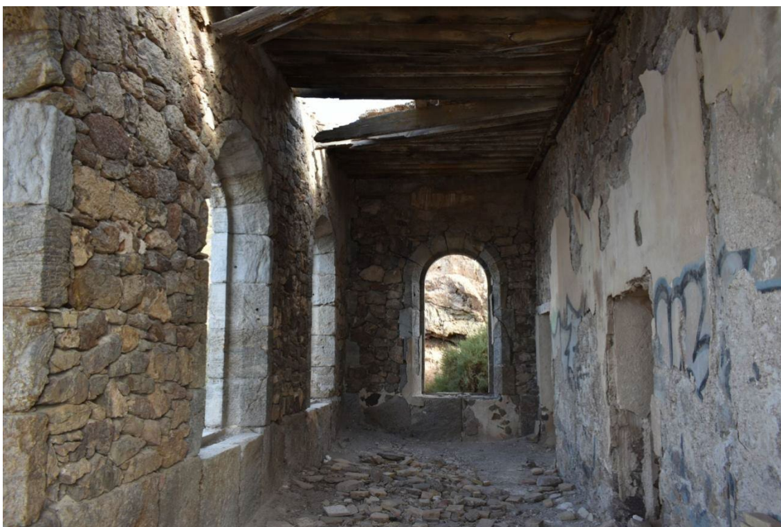
Imagen 6. Dependencias traseras del Faro de la Podadera. Nótese los escasos enlucidos que perviven en sus muros. Fotografía de los autores.
